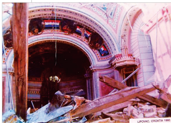
LIPOVAC, župna crkva sv. Lovre teško oštećena tijekom 1992. g.
