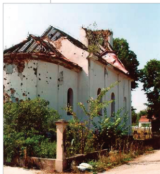
DELETOVCI, filijala župe Nijemci, teško oštećena crkva sv. Ivana Kapistranskog čiji je inventar u potpunosti izgorio
