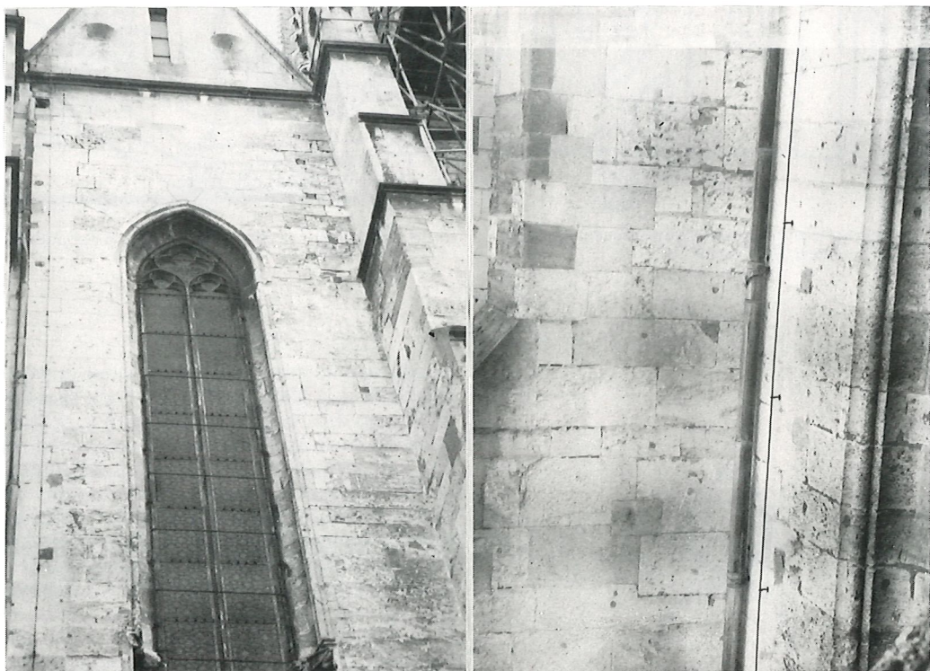
Sl. 1. Zagrebačka katedrala, rupe za dizanje "mačkom" na zidu sjeverna broda: one su kasnije ispunjene mortom (foto: D. Foretić)
